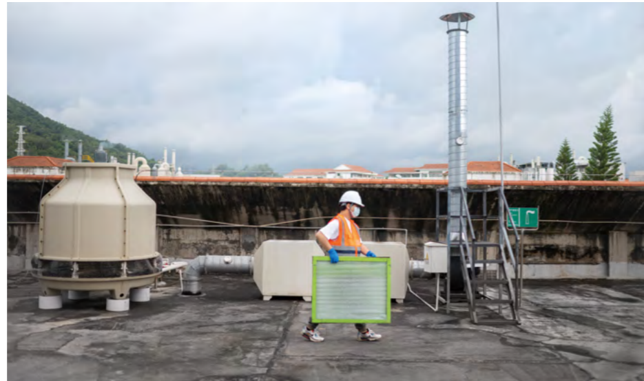
工作人员操作废气处理装置
